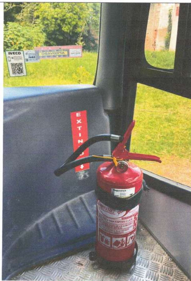
Foto 5: Extintor de Incêndio
