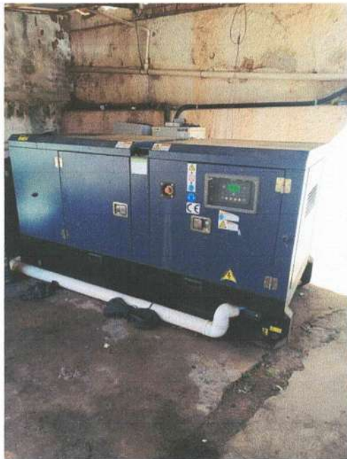
Fotografia 17 – Gerador Gerador de energia.
